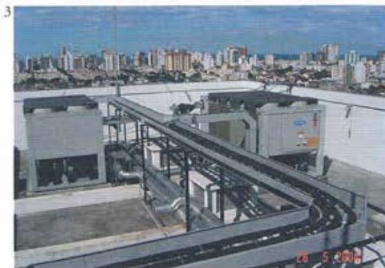
1 - Vista noturna do empreendimento; 2 - Fachada principal; 3 - Unidade resfriadora ( chiller ), localizado a 48 metros de altura.
