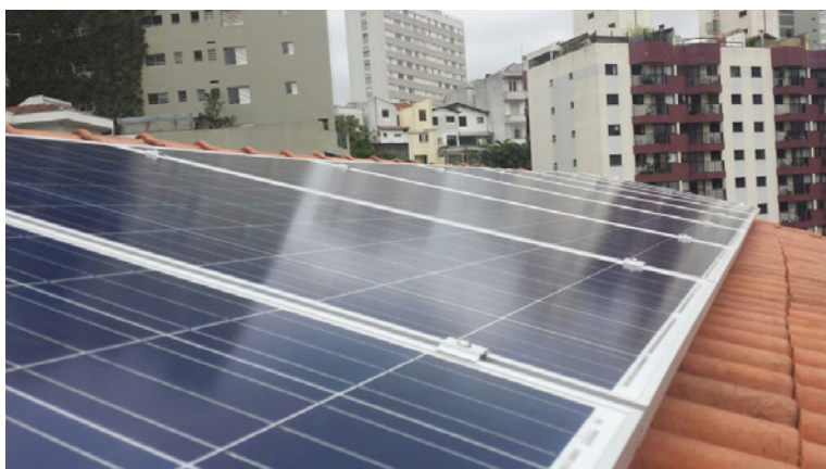
Sistema fotovoltaico da sede do IPH. Fonte: Sostício Energia
