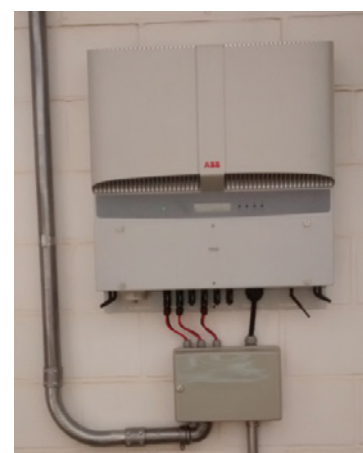
Figura 13: Exemplo de instalação de inversor fotovoltaico tipo string
