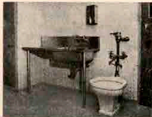
Fig. 15 — Sala de Sub-Esterilização do Kitchener-Waterloo Hospital. — Pia, despejo para lavagem da enxaguão e porta do armário de material de limpeza.
