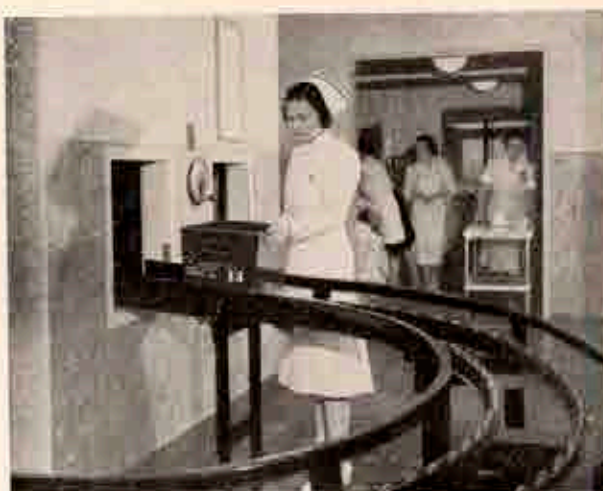
Fig. 53 — "Conveyor" ou monta-carga de descarga automática do Hartford Hospital.
