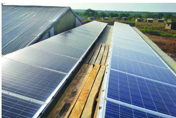
Figura 17: Hospital que recebeu doação de sistema autônomo ( off-grid ) com capacidade de 19kW no norte do Benin, que abastece o almoxarifado e o refeitório local Fonte: MORAGUES, 2015
