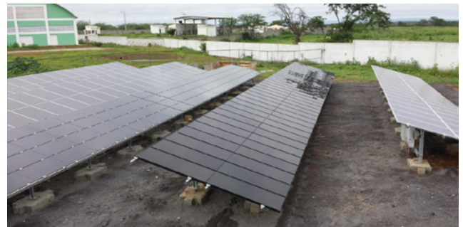
Figura 8: Usina Fotovoltaica de Pesquisa IFBA Irecê, interior da Bahia, uma das regiões com maior insolação do Brasil
