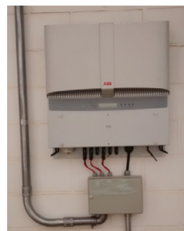
Figura 13: Exemplo de instalação de inversor fotovoltaico tipo string
