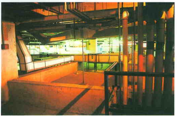
Desenvolvido por Jarbas Karman, o andar técnico facilita a colocação e manutenção das instalações do hospital
